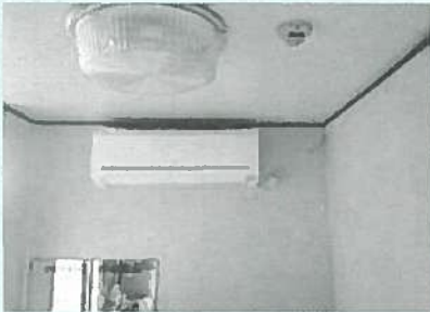
脱衣所に空調設備の導入(旅館業)
